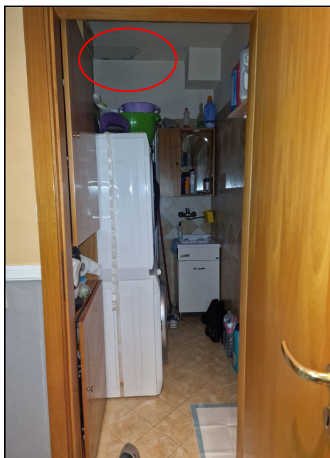
Foto 11: vista della lavanderia. Si notino lievi tracce di infiltrazioni sul soffitto.
