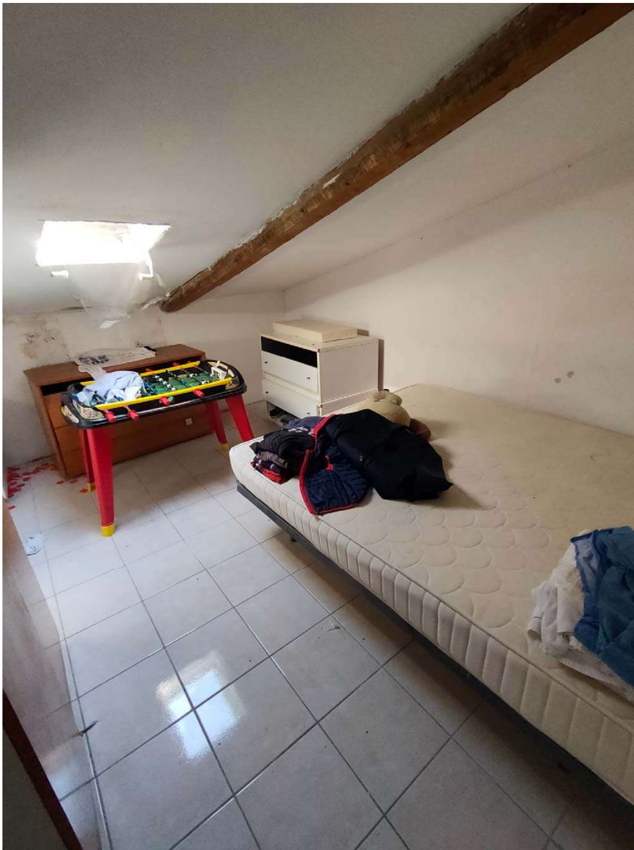
FOTO 24: CAMERA 3 IN PESSIMO STATO DI CONSERVAZIONE E MANUTENZIONE AL PIANO SOTTOTETTO CON LUCERNAIO IN COPERTURA.
