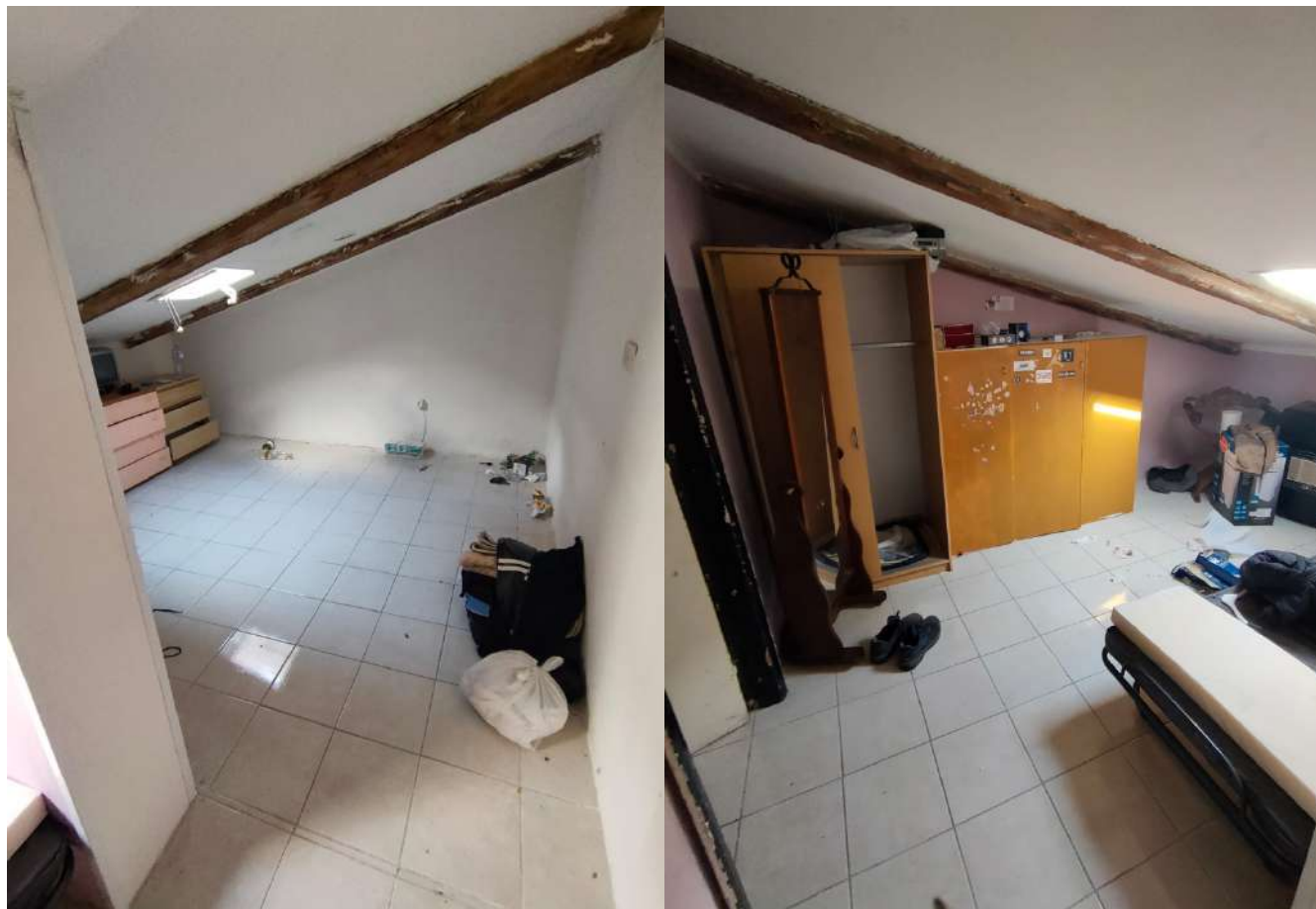
FOTO 25 - 26: CAMERA 2 IN PESSIMO STATO DI CONSERVAZIONE E MANUTENZIONE AL PIANO SOTTOTETTO CON DOPPIO LUCERNAIO IN COPERTURA
