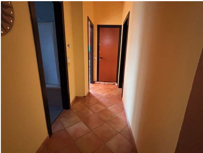
Disimpegno (con chiusura verso il p.t. difformità)
