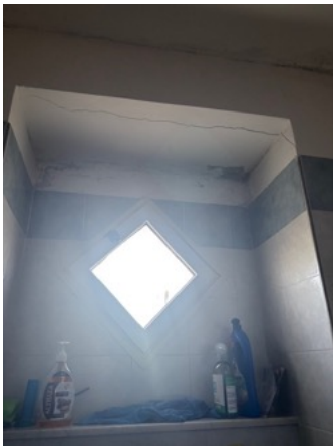
Fotografia n. 9 - Elementi di degrado bagno (vano 5)
