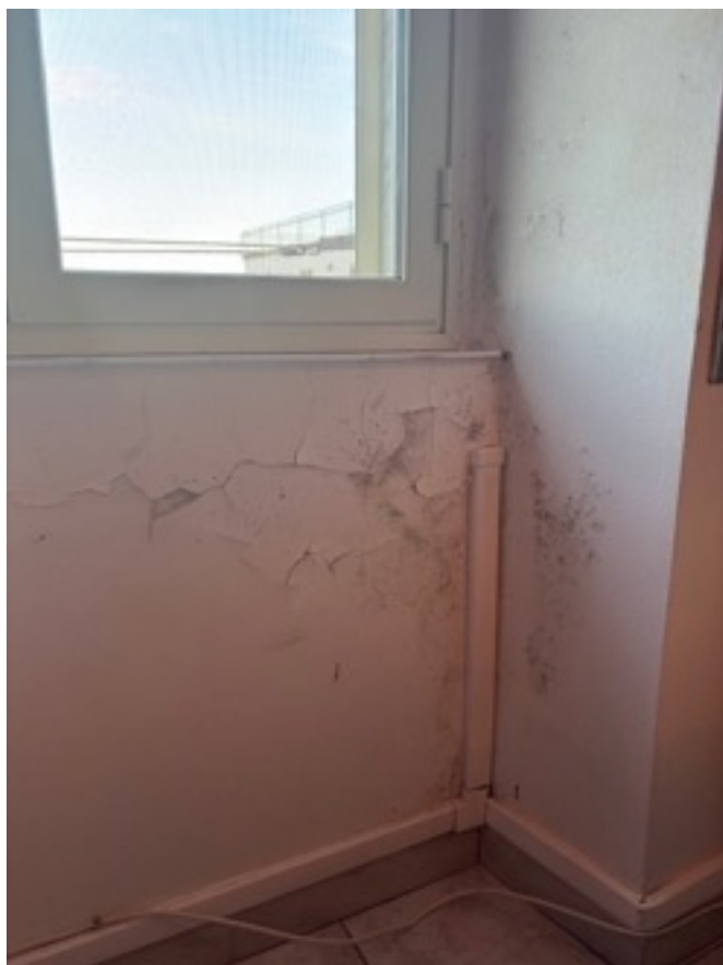
Fotografia n. 10 - Elementi di degrado camera (vano 3)
