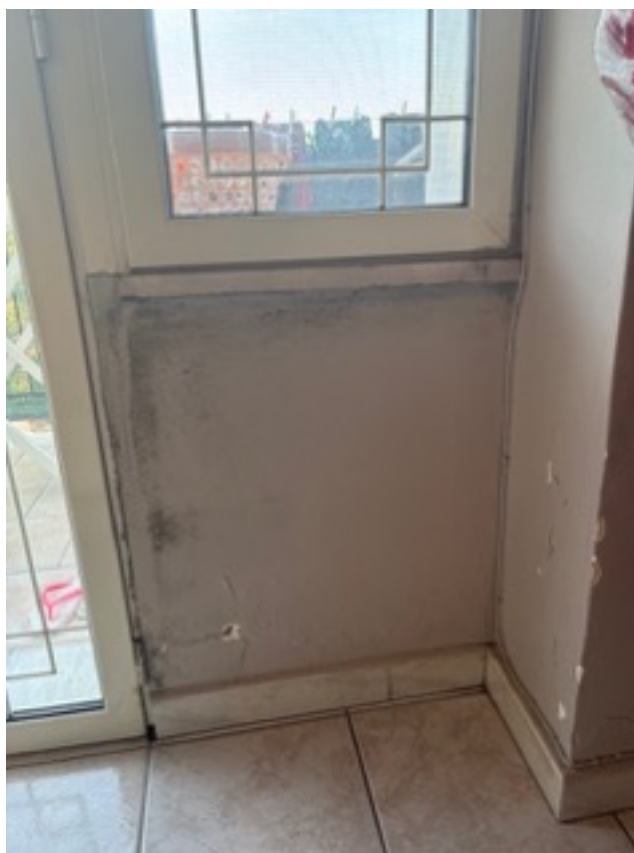
Fotografia n. 8 - Elementi di degrado zona soggiorno (vano 1)
