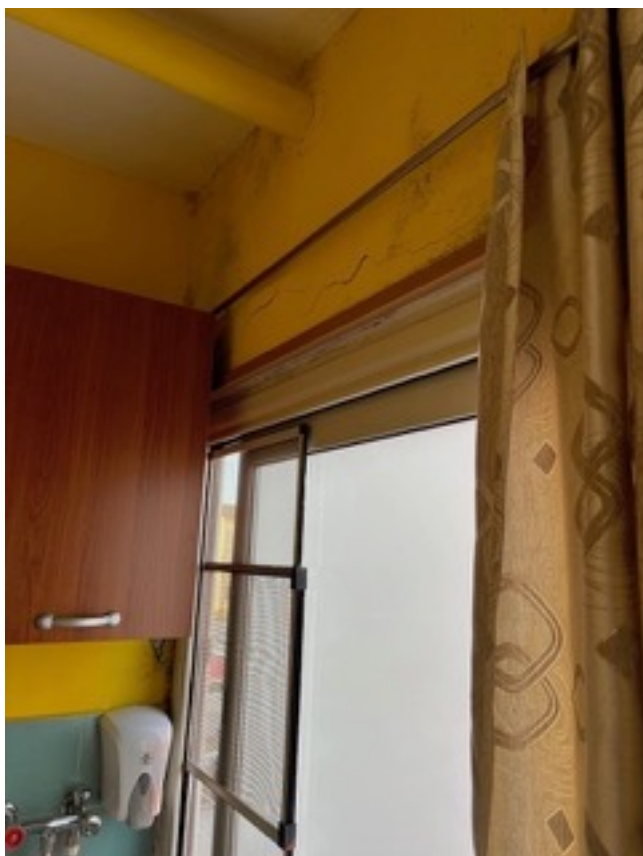
Fotografia n. 7 - Elementi di degrado angolo zona cucina/soggiorno (vano 1)
