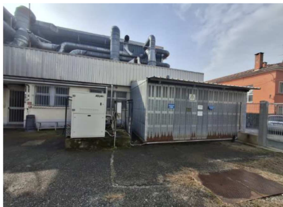
Centrale termica e trasformatori
