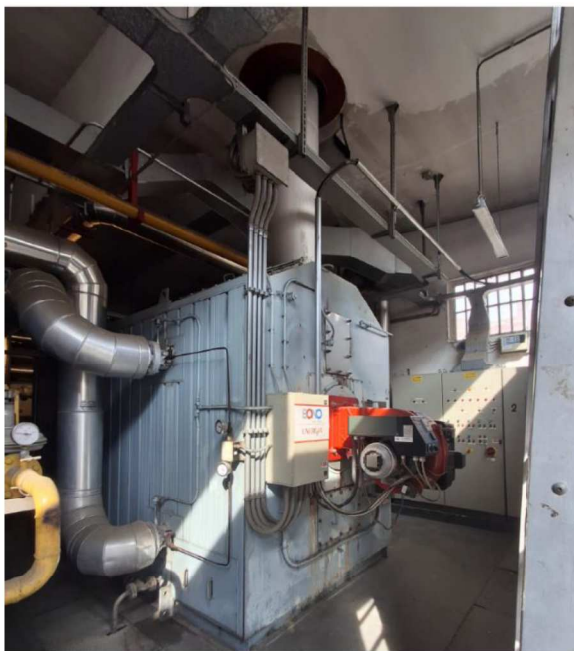
Locale pompe – n. 6
