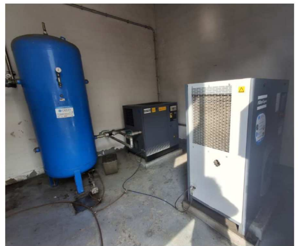
Locale compressori – n. 7
