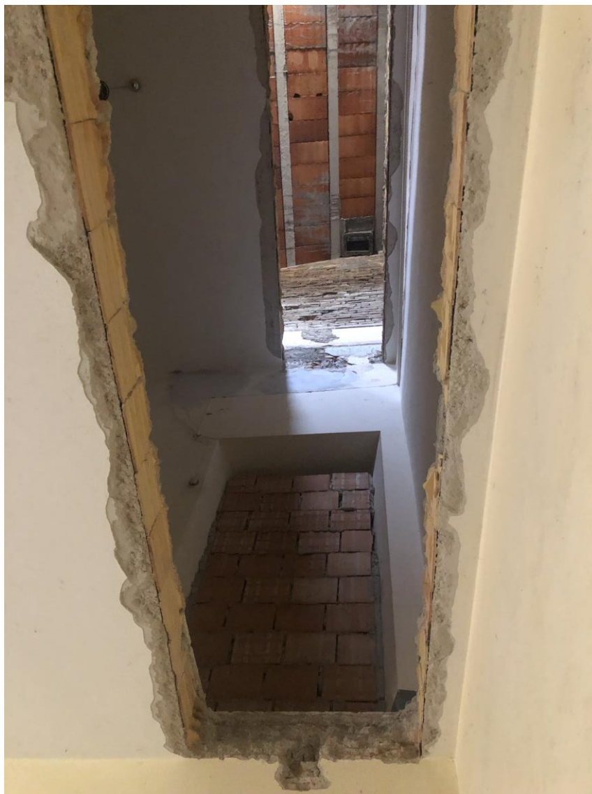
FOTO N. 06 – Viste di fori nei solai eseguite con pratica edilizia depositata
