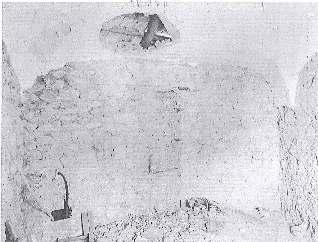
BUCA NEL SOTTOTETTO AL PRIMO PIANO
