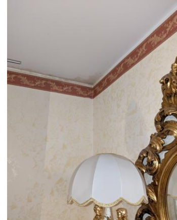
Foto 18: Tracce di umidità sul soffitto della camera
