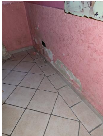
Foto 17: Tracce di umidità di risalita
