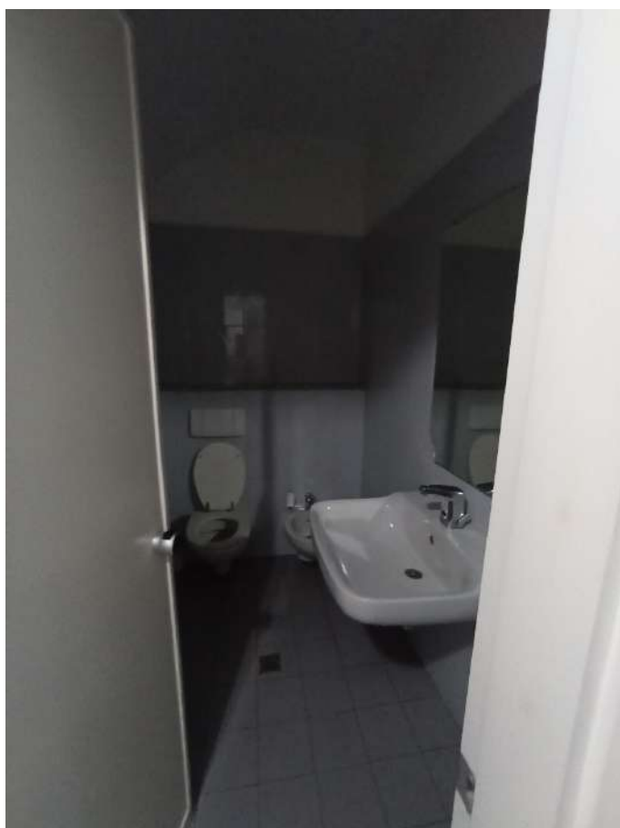
Foto 110 – Bagni di Servizio
