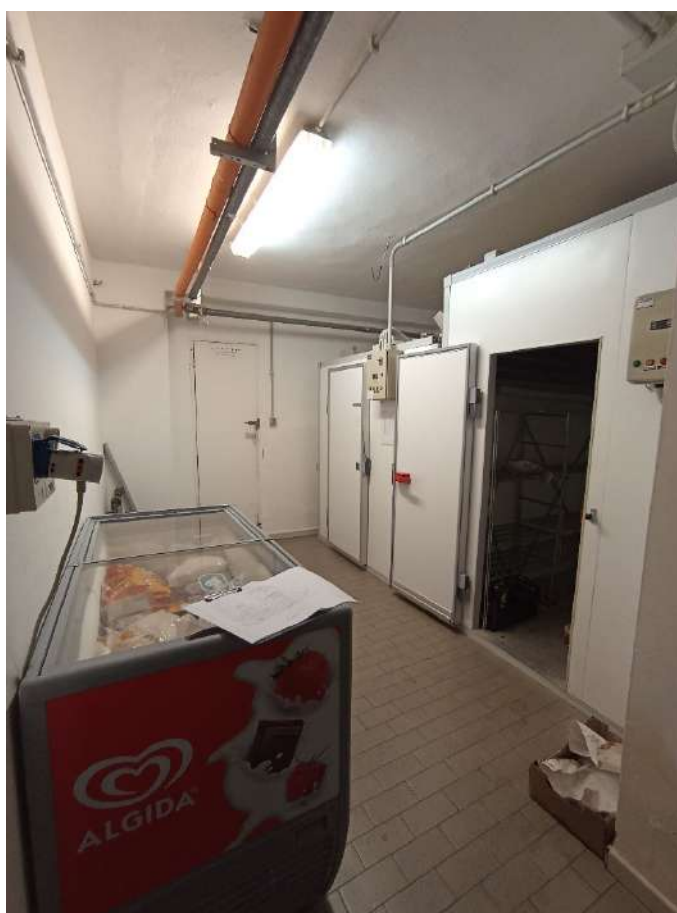
Foto 104 – Zona Celle Frigo
