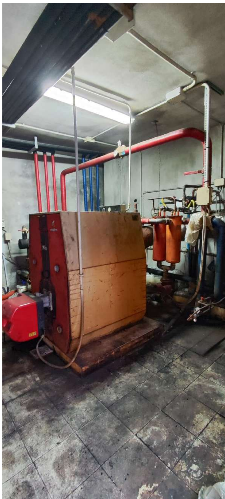
Foto 112 – Dettaglio Centrale Termica
