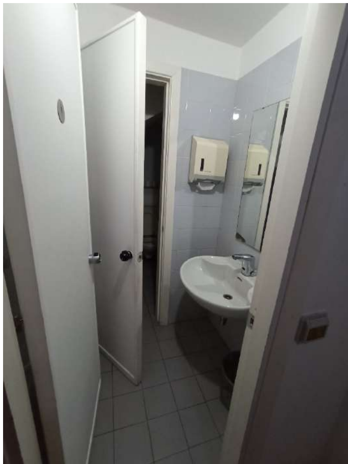
Foto 109 – Bagni di Servizio
