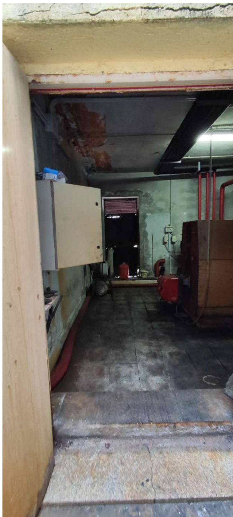
Foto 111 – Ingresso Centrale Termica
