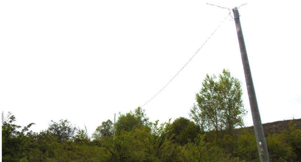
Lotto n. 2 – Particolare linea elettrica
