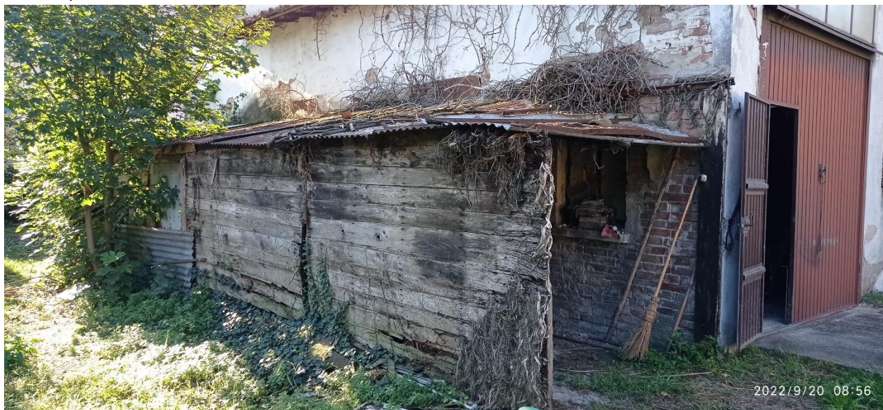
Foto 6: baracche abusive da demolire
