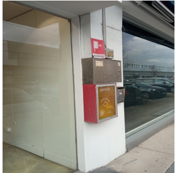
Foto n. 30 – Cassetta dell'idrante condominiale
