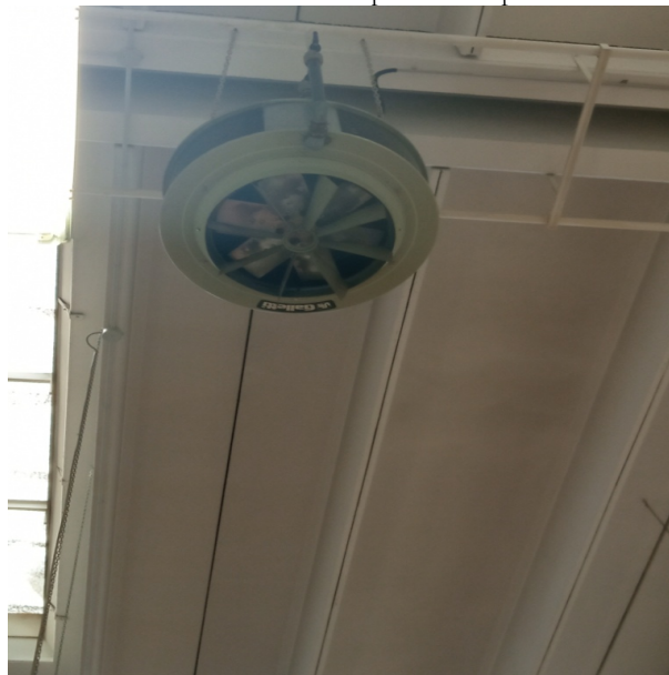
Foto n. 32 – Aerotermi nell'area deposito del capannone
