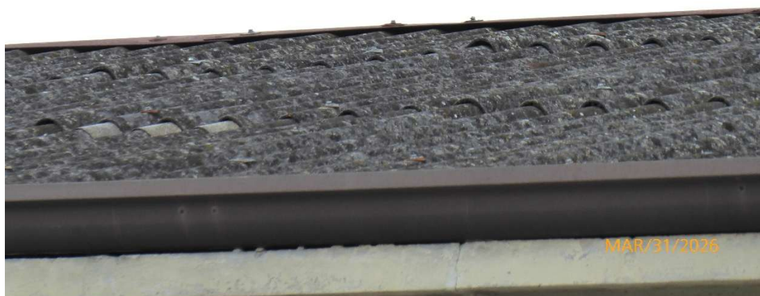
MANTO DI COPERTURA DI ETERNIT
