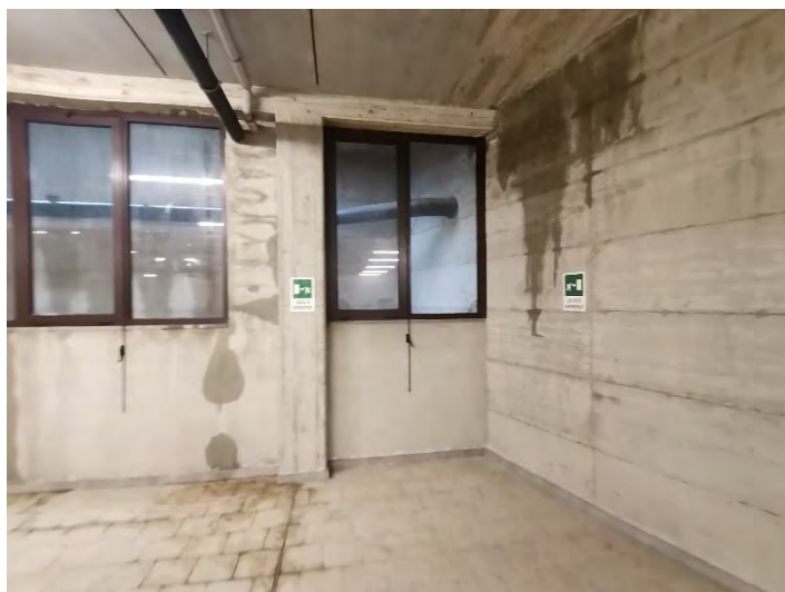
Infiltrazioni dalla parete
