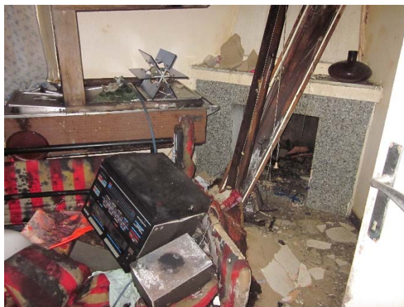
Foto 15. Il soggiorno: a terra l'intonaco del soffitto.
