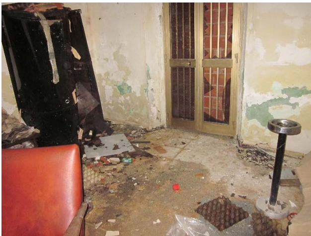
Foto 10. Le condizioni della camera padronale.
