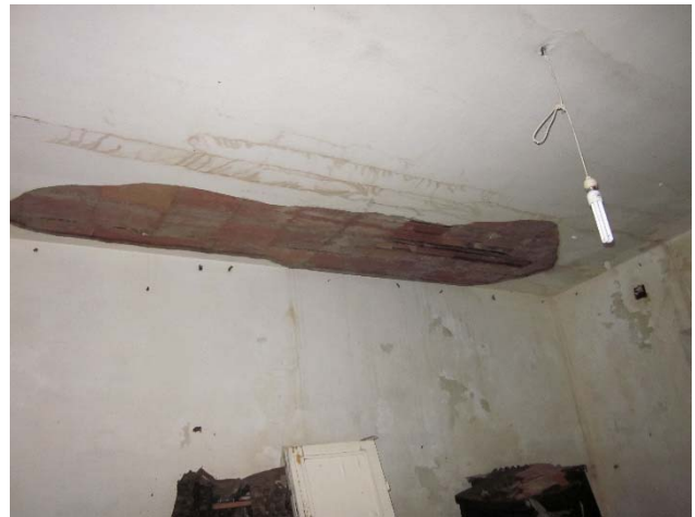
Foto 9. Il soffitto sfondellato della camera padronale.
