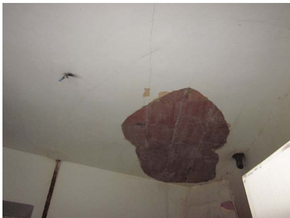
Foto 16. Problemi al soffitto del soggiorno.
