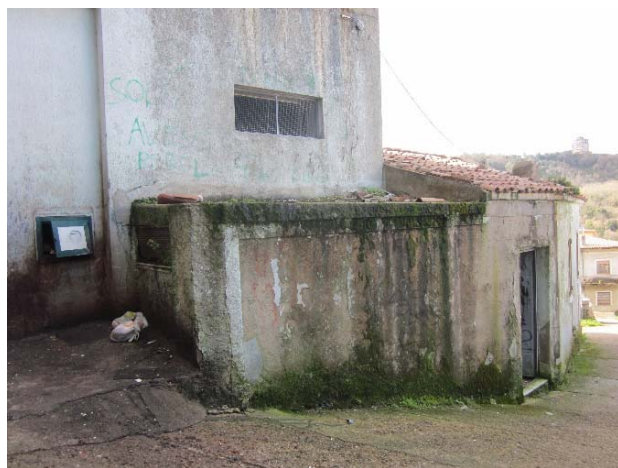
Foto 25. Il vano abusivo visto da via della Pineta.
