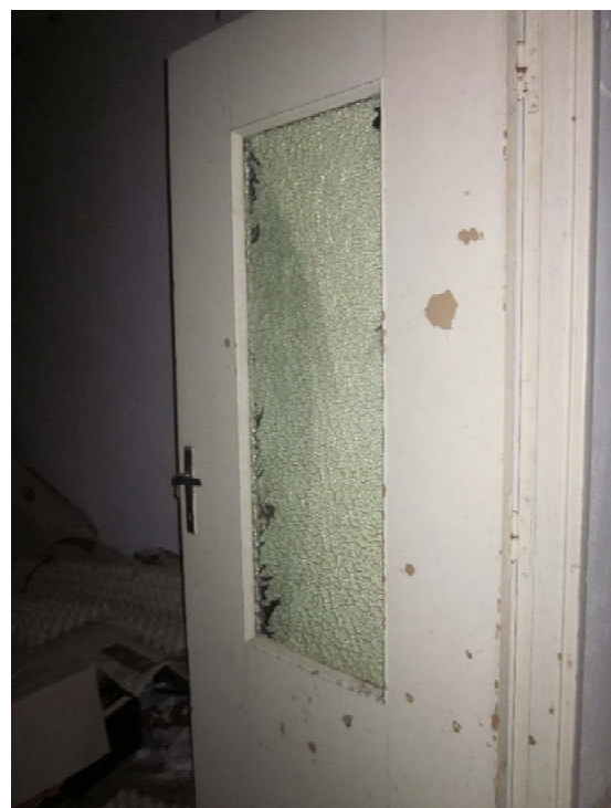
Foto 13. Condizioni delle porte interne.
