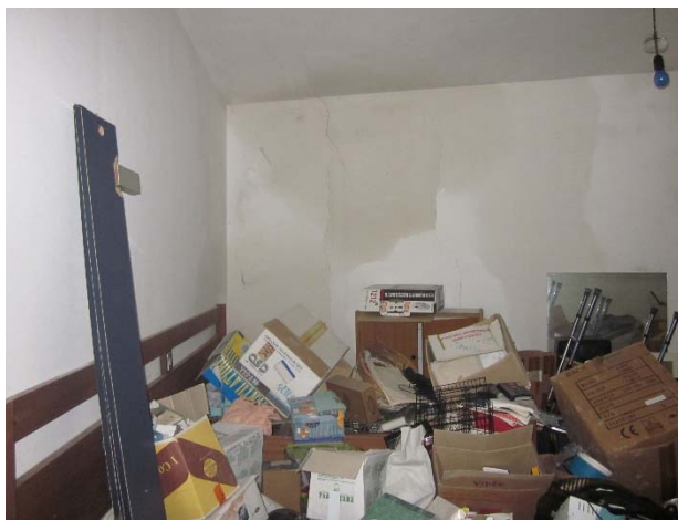
Foto 22. La seconda camera: la parete bagnata sul fondo.
