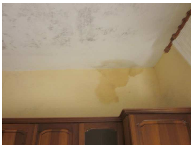
Foto 11. Interno: piano terra: macchie umidità in soggiorno.
