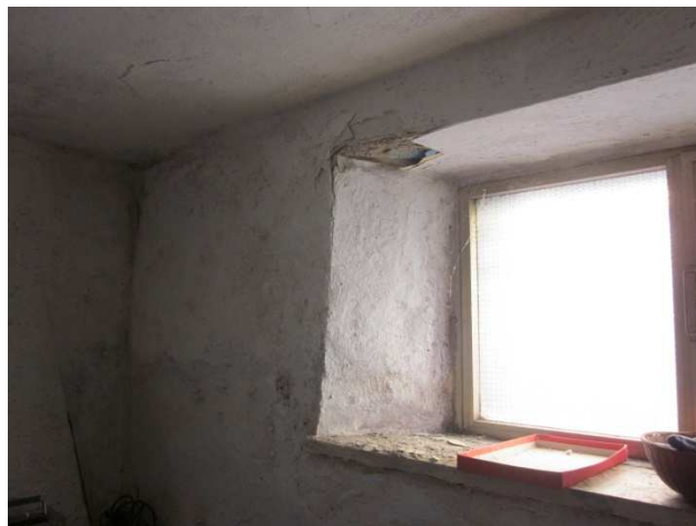
Foto 21. Interno: seminterrato: problemi all'intonaco.
