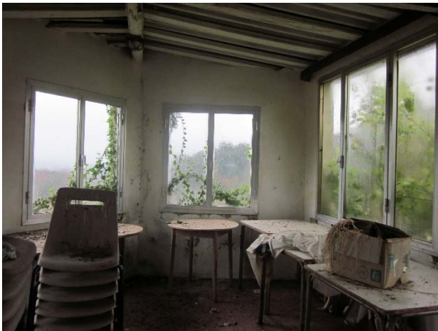
Foto 28. La veranda chiusa abusiva.
