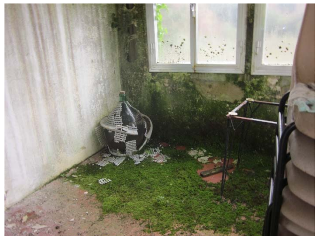
Foto 31. Muschi sulla pavimentazione della veranda chiusa.
