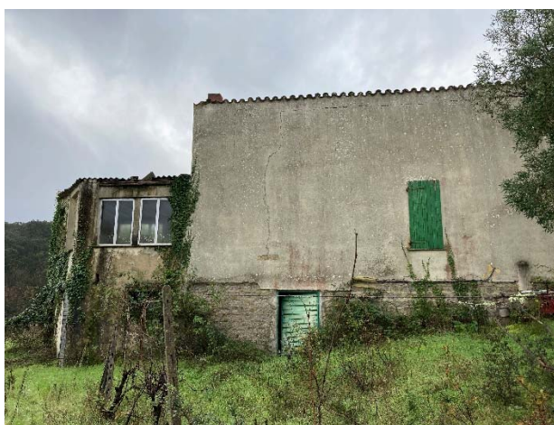
Foto 18. La facciata nord del fabbricato, con la parte in abuso.
