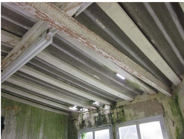
Foto 30. La copertura fatiscente della veranda.
