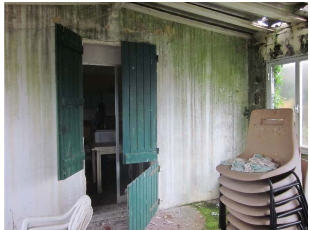
Foto 29. La parete ammalorata della veranda chiusa.
