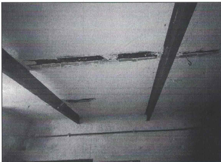
-Ossidazione putrelle in ferro-
