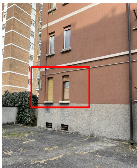
vista finestre bagno di cui una tamponata internamente
