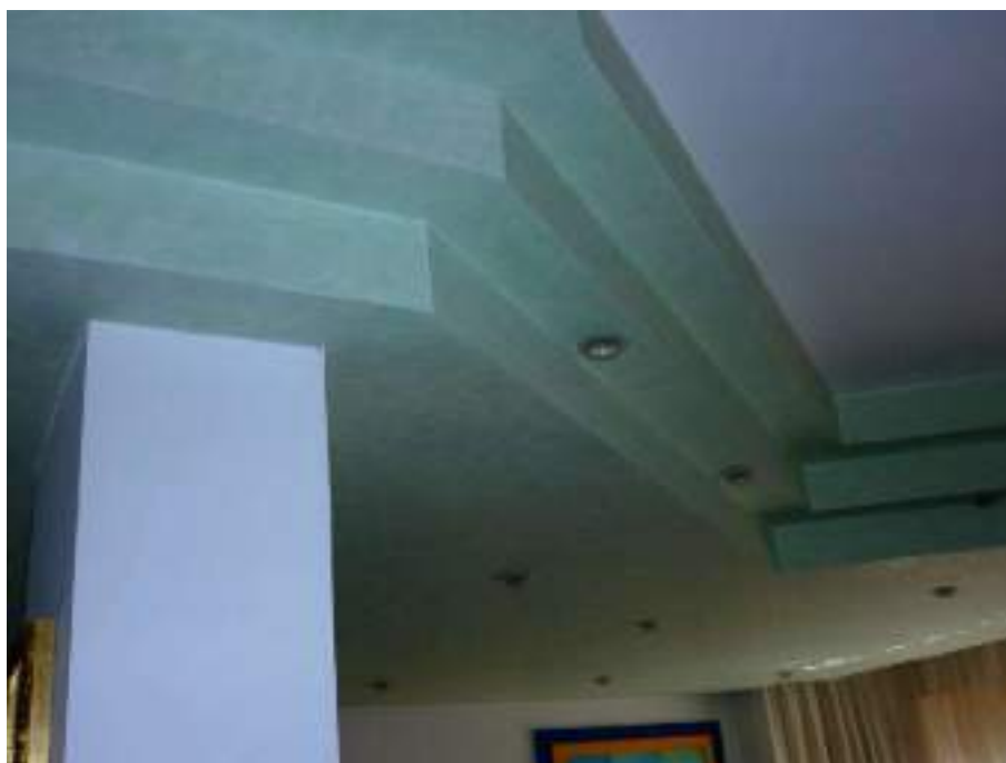
Figura 6 - APPARTAMENTO: Particolare controsoffittatura con impianto di illuminazione
