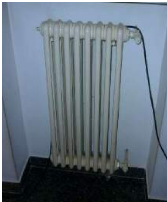
Figura 10 - APPARTAMENTO: Radiatore impianto di riscaldamento
