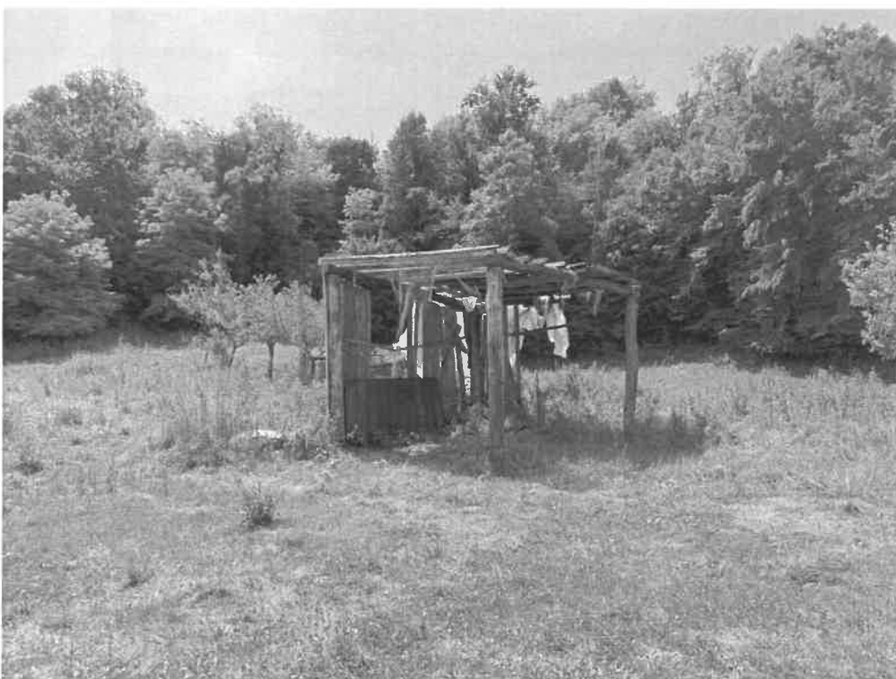
Foto 07: tettoia abusiva insistente sulla particella 127
