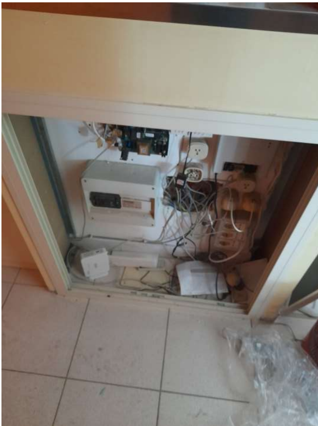
Foto n. 42 – INTERNO PIANO 1 - CENTRALINA TELEFONICA
