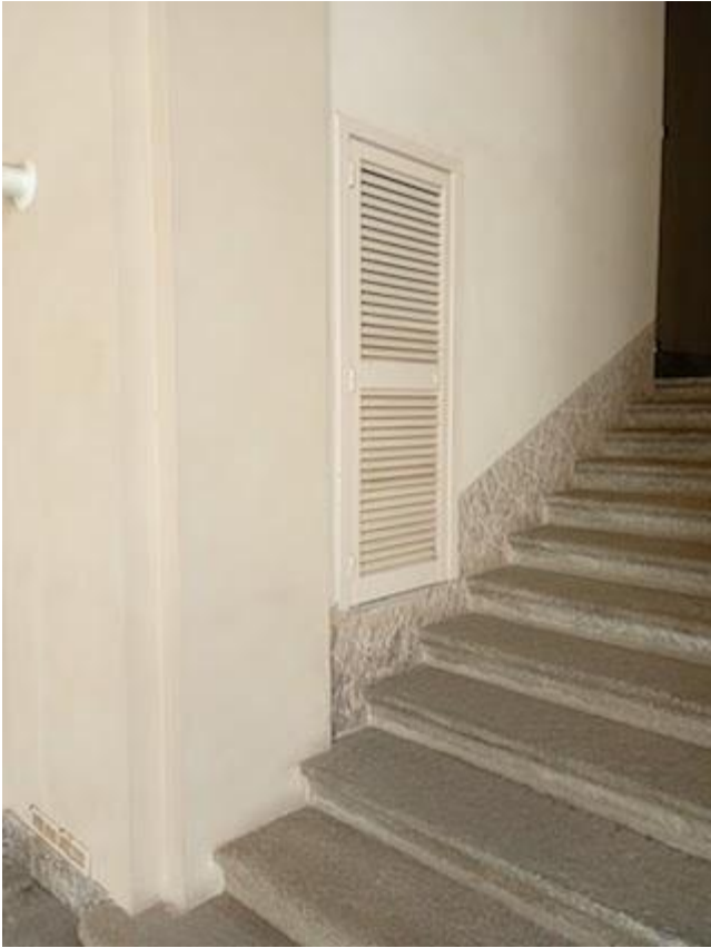
Porta locale caldaia presente nel vano scala condominiale
