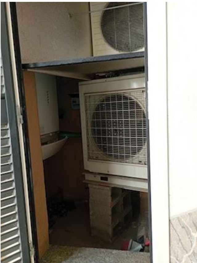
Interno locale caldaia
