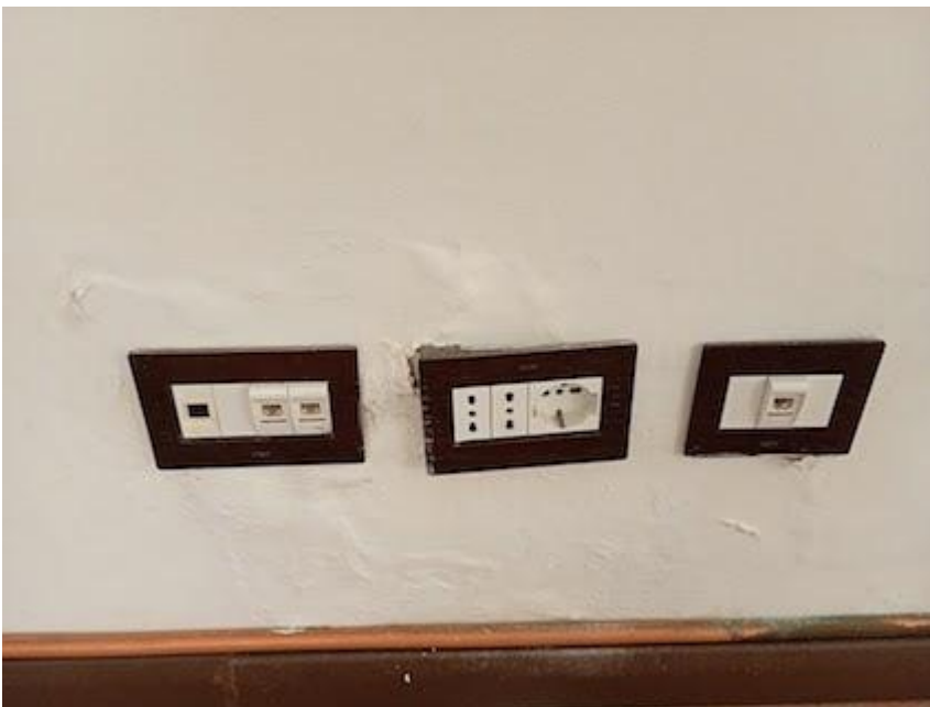
Particolare impianto elettrico
