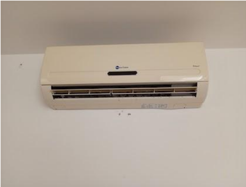
Split impianto condizionamento
