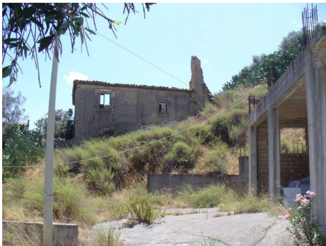
FOTO N. 17 – fabbricato diruto fg 10 part. 4 -
