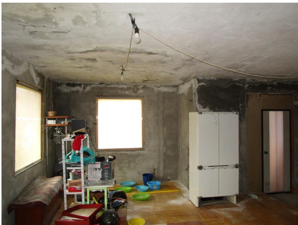
Foto 35 – Porzione di appartamento al piano primo con presenza di infiltrazioni
