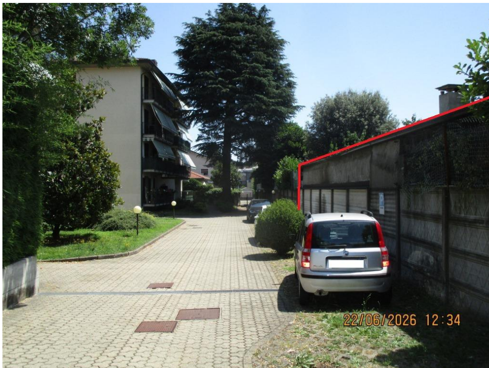
Foto 49 – Retro della dependance in aderenza e sovrapposizione al muro di confine verso altrui proprietà
