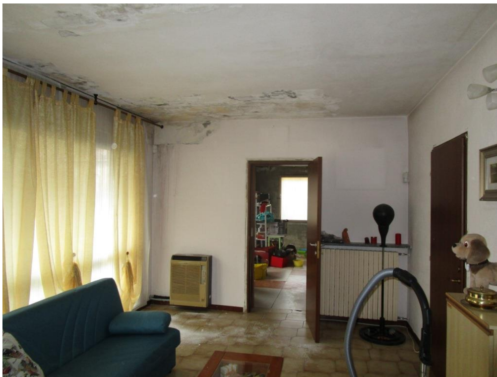
Foto 34 – Porzione di appartamento al piano primo con presenza di infiltrazioni
