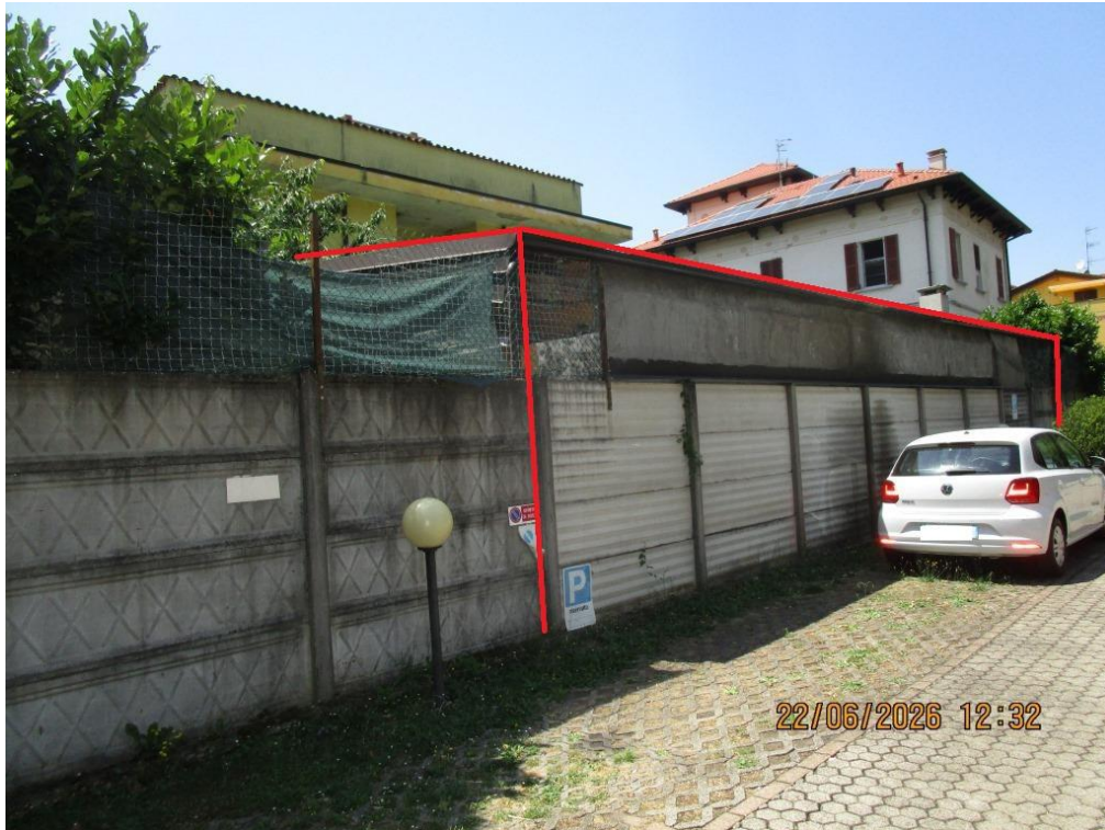
Foto 48 – Retro della dependance in aderenza e sovrapposizione al muro di confine verso altrui proprietà
