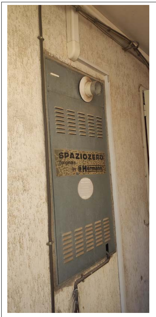
Foto 46 Sportello della caldaia del gas
