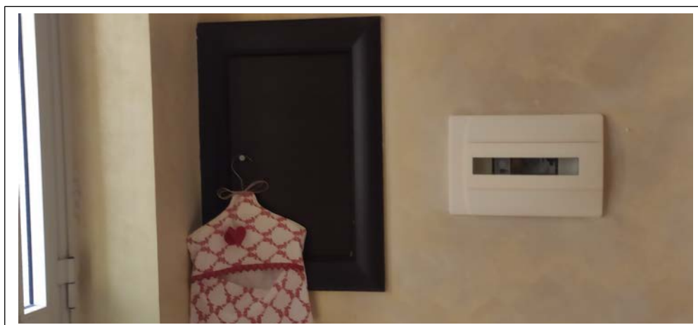
Foto 48 Sportello contatore energia elettrica
