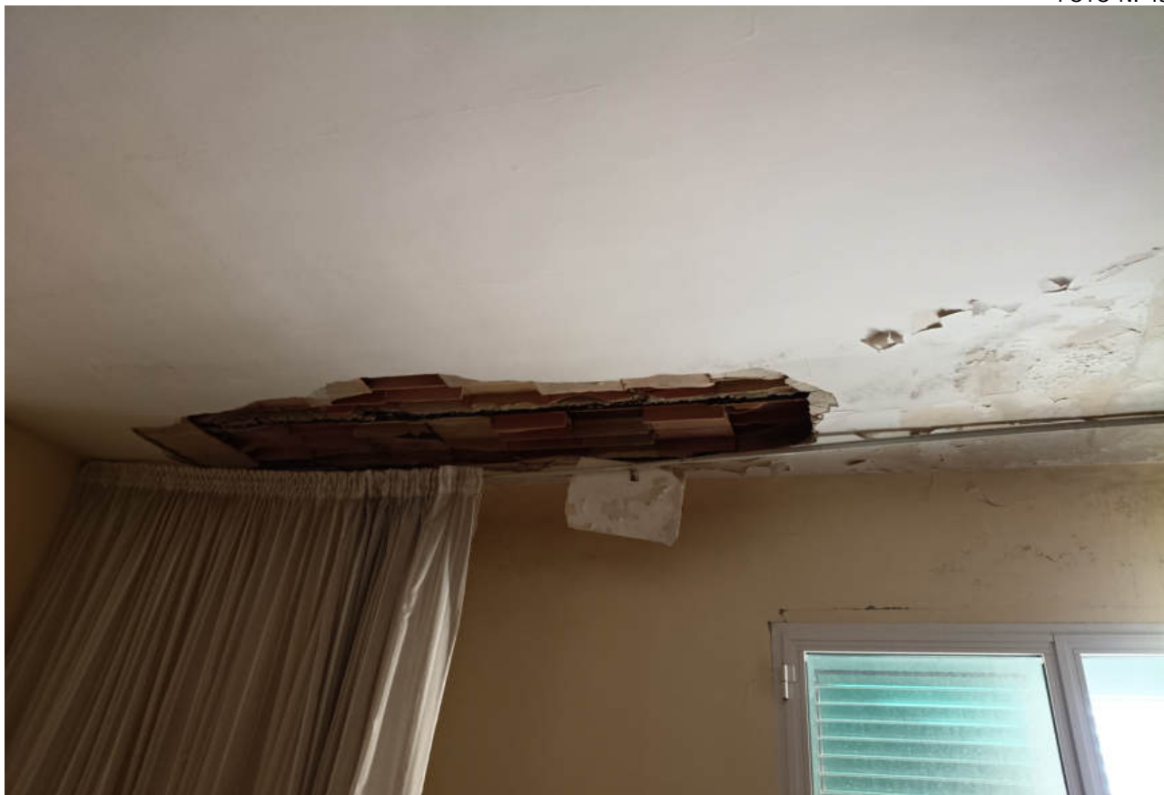
DANNI SOLAIO VANO SOGGIORNO
