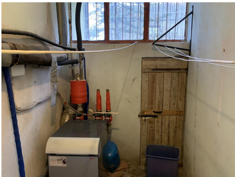
LOCALE CALDAIA PIANO SEMINTERRATO
