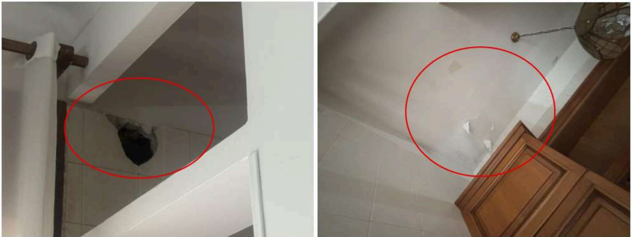
Fig. 27-28: dettagli di taluni fenomeni di degrado nelle porzioni a soffitto e negli spigoli superiori dell'ambiente cucina, il primo rappresenta l'impianto di areazione fumi cucina privato della griglia e occluso e il secondo rappresenta esfoliazioni di intonaco dovute a infiltrazioni d'acqua dalla copertura.
