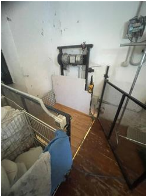
montacarichi esistente da rimuovere
