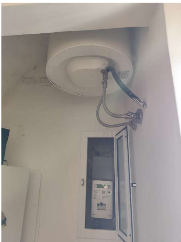
FOTO N. 9 – PARTICOLARE BOYLER ELETTRICO
