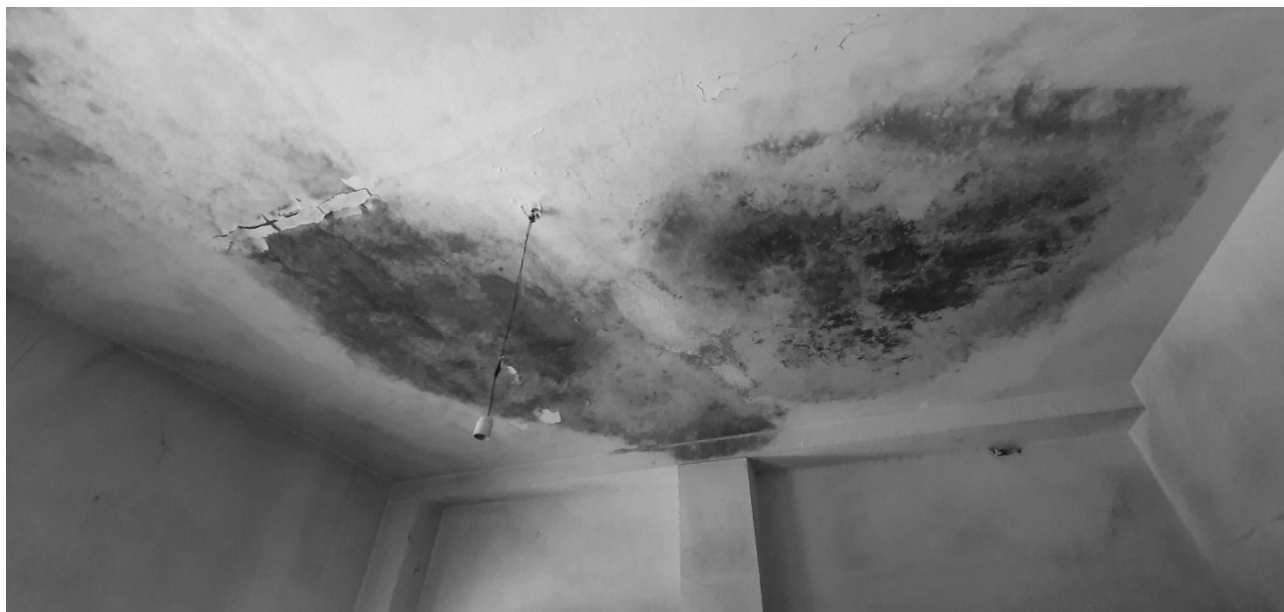
FOTO 7 (piano T zona solaio soffitto con infiltrazioni)
