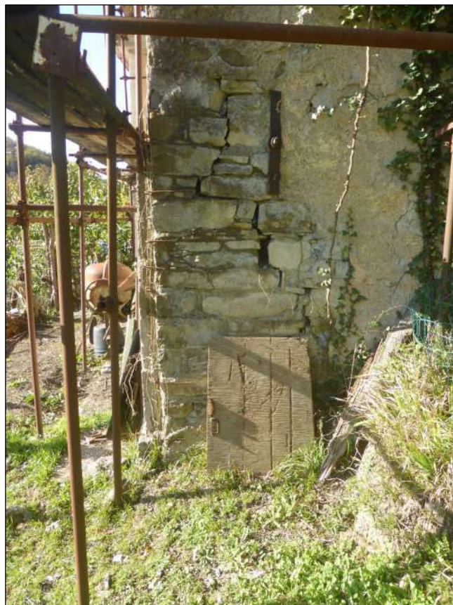
FOTOGRAFIA N. 19 Particolare della predetta lesione
