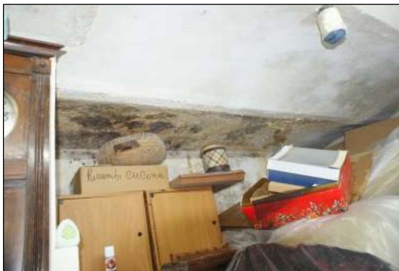
Soppalco. Lungo la parete confinante con la stanza 2 e all'intradosso del solaio segni di eventi infiltrativi.
