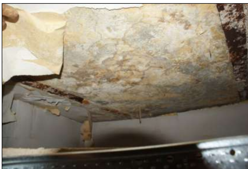
Stanza 3. L'intradosso del solaio, con segni di eventi infiltrativi.
