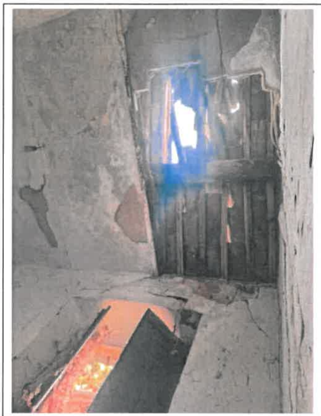
Foto n. 5 – Vista interna immobile in oggetto Parte crollata
