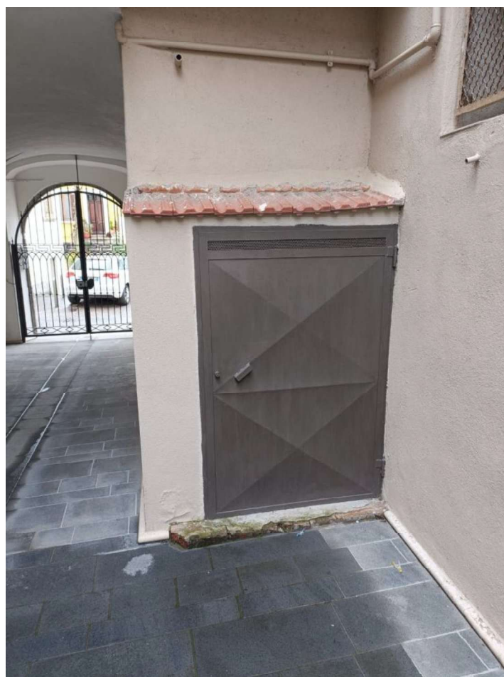
Figura 24 – Deposito su corte interna.
