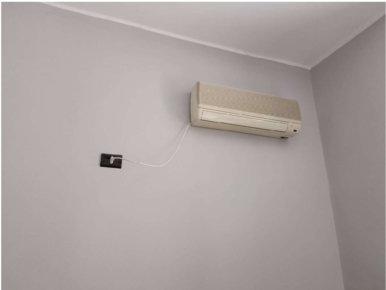
Figura 21 – Particolare Split locale Via Floriano Del Zio, n. 73.
