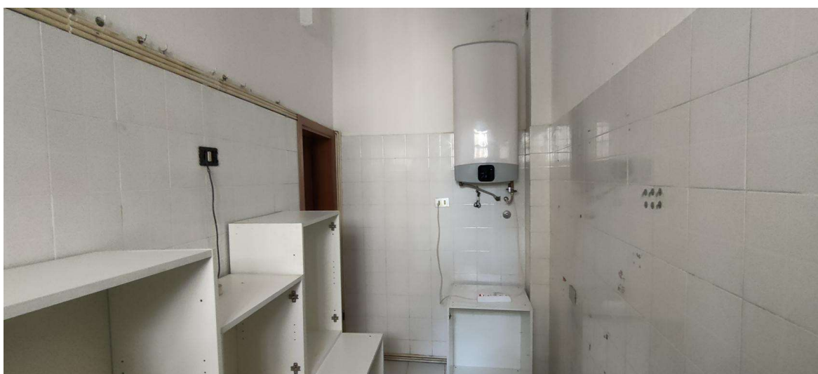
RIPOSTIGLIO AL PIANO TERRA CON SCALDA ACQUA
