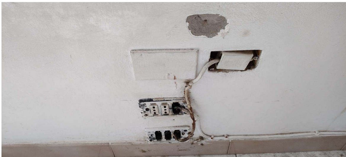
PARTICOLARE IMPIANTO ELETTRICO
