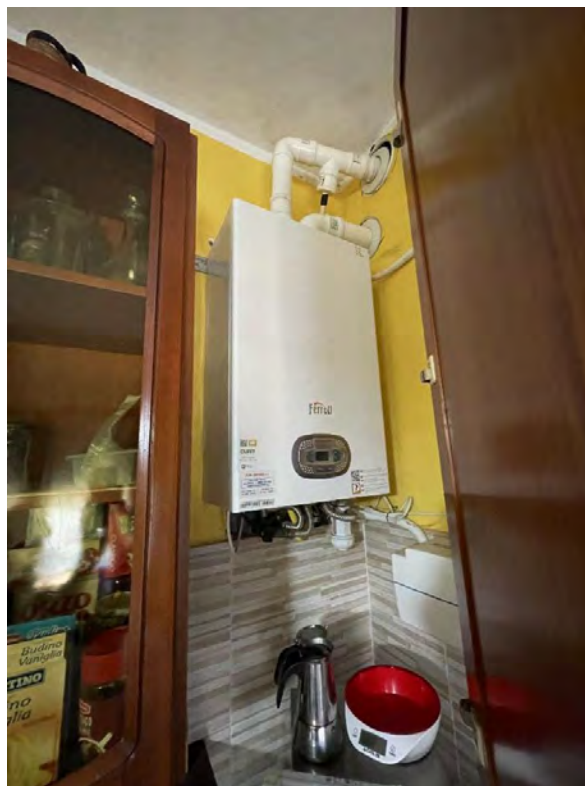
18. Caldaia ubicata in cucina.
