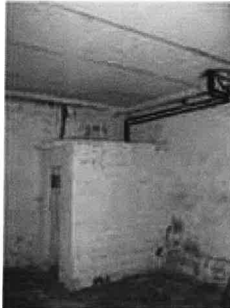
Centrale termica all'interno del magazzino al piano terra civico 22, si nota la caldaia priva di bruciatore
