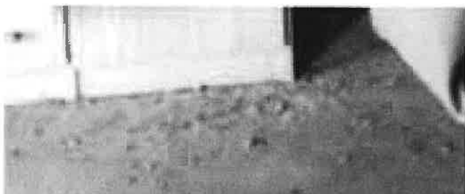
Sottotetto lato ovest, piano di posa per la pavimentazione che risulta assente
