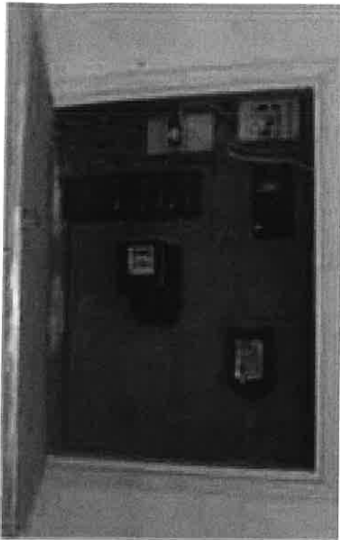
Quadro elettrico nel soggiorno al piano terra
