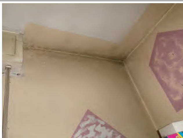
Dettaglio presenza di umidità camera da letto - 3°P
