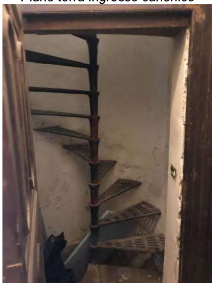
La scala per interrato
