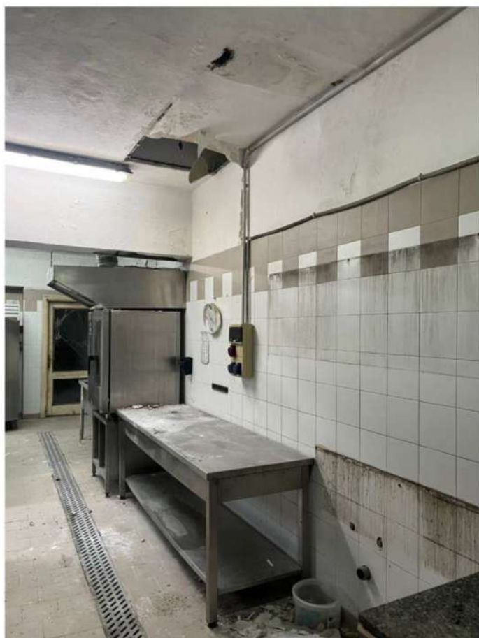
Cucine del ristorante
