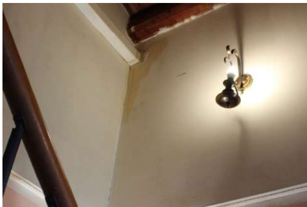
Foto n.23: Macchie da infiltrazione su muratura perimetrale
