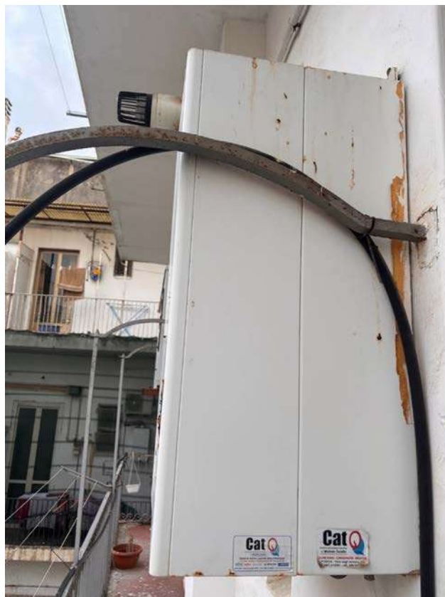
Foto 22: particolare alloggiamento caldaia
