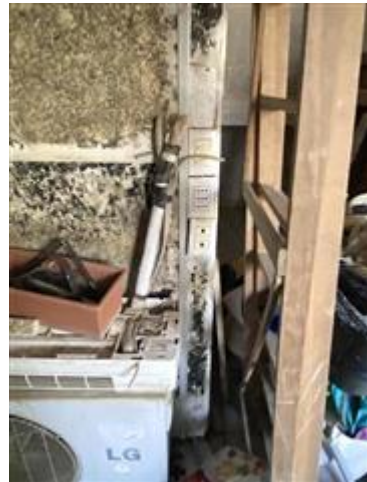
part. impianto elettrico
