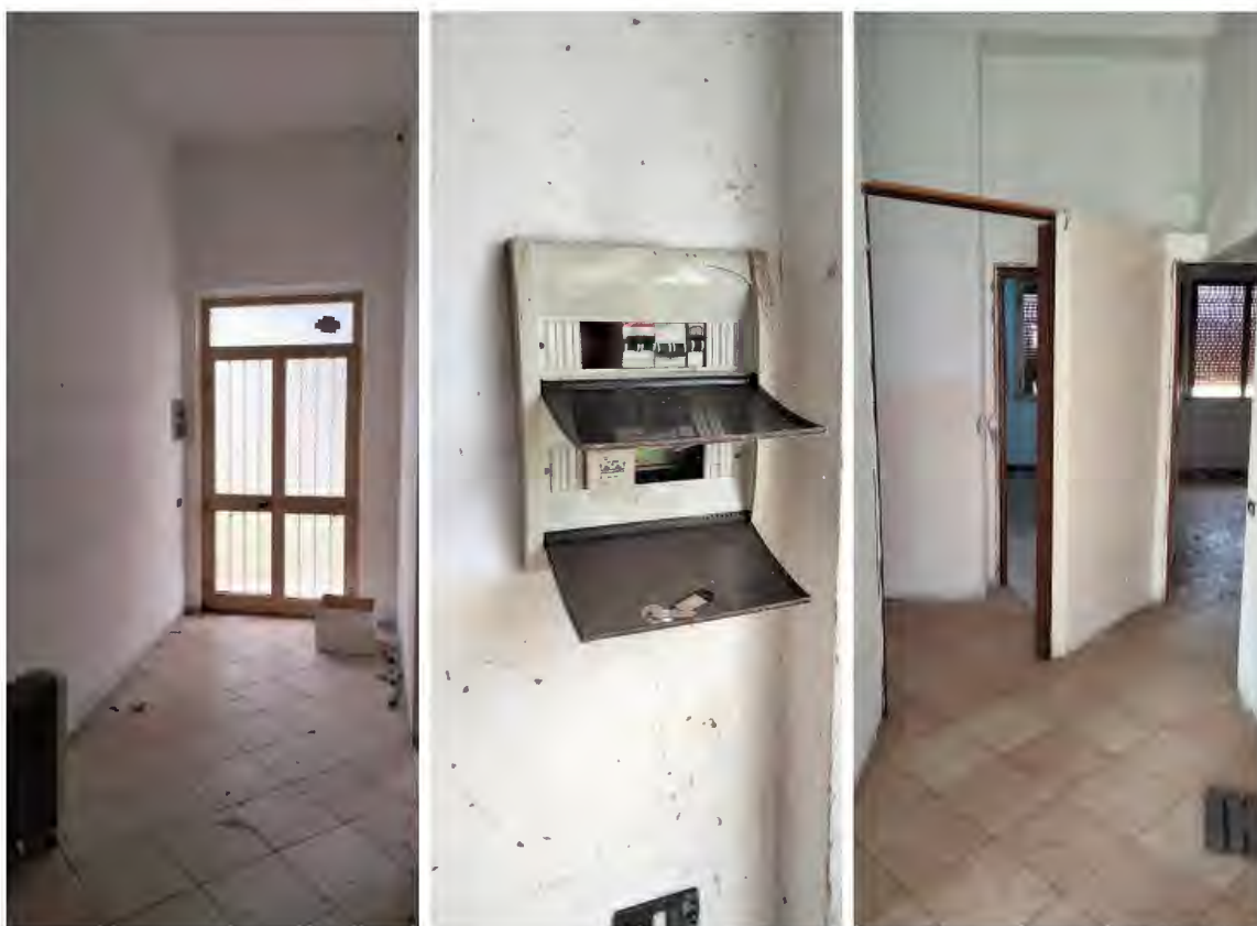
Foto 46 – C.F. Part. 181 / PT ingresso zona uffici – particolare quadro
