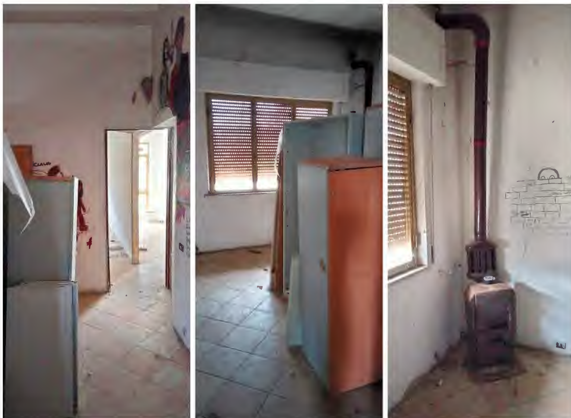
Foto 45 – C.F. Part. 181 / PT ufficio 4 – particolare stufa
