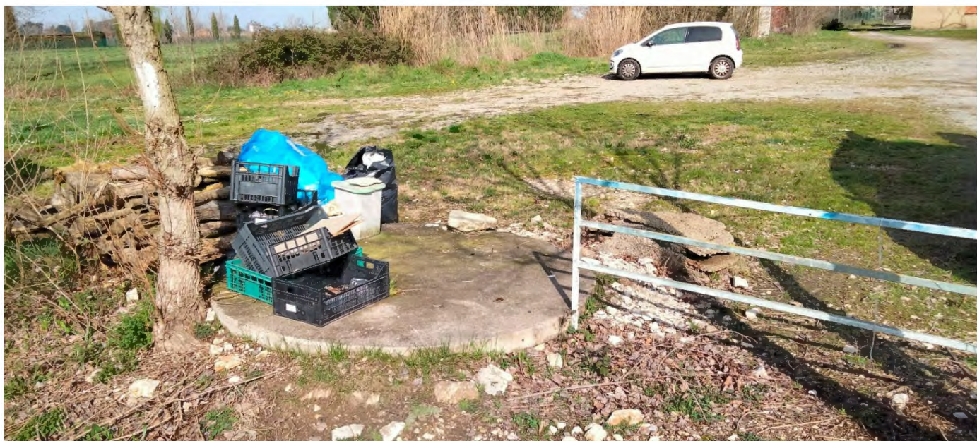
Foto 19 – particolare fossa Imhoff
