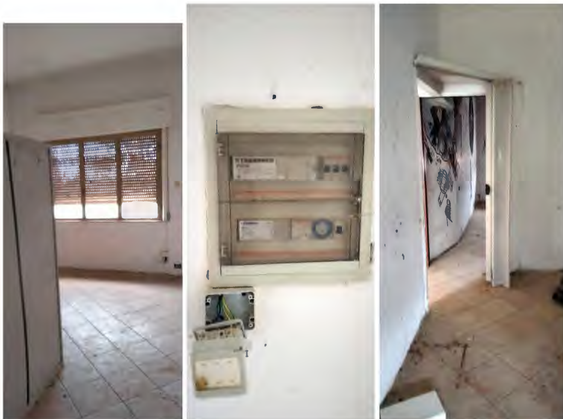
Foto 44 – C.F. Part. 181 / PT ufficio 3 – particolare quadro
