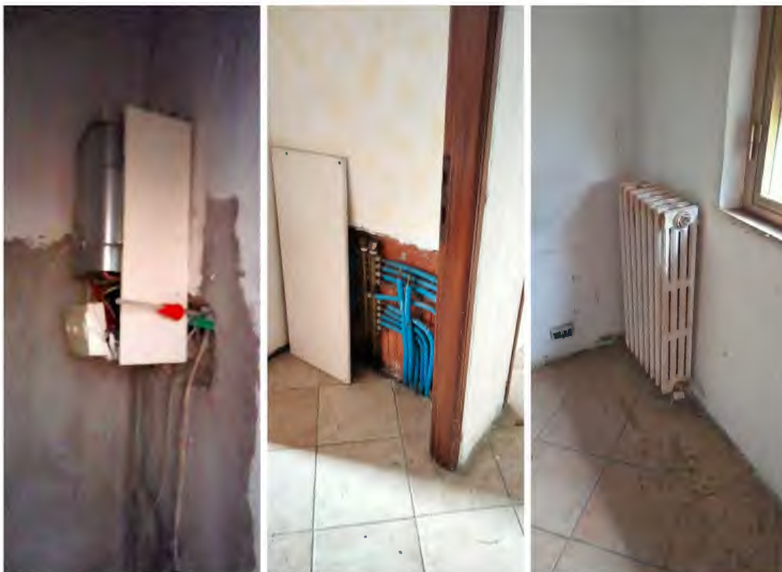
Foto 47 – C.F. Part. 181 / PT particolari impianto riscaldamento
