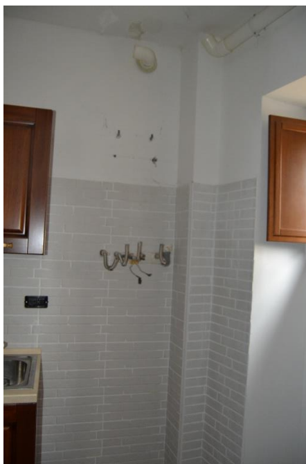
19 – L'attacco per la caldaia nel soggiorno.
