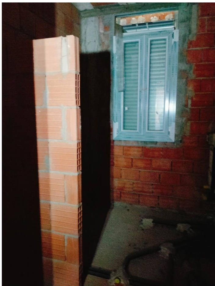
FOTO 13 – P.2°: Servizio igienico 2
