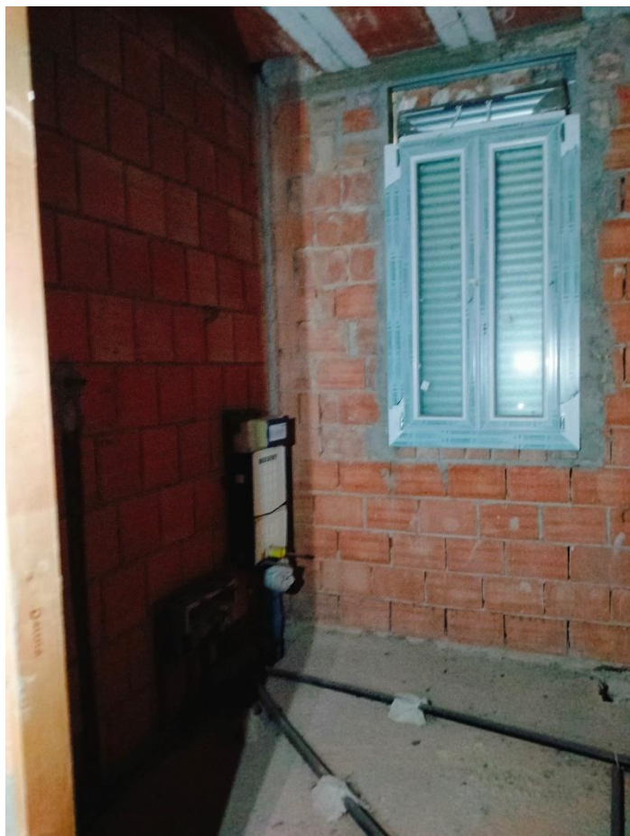
FOTO 14 – P.2°: Servizio igienico 2
