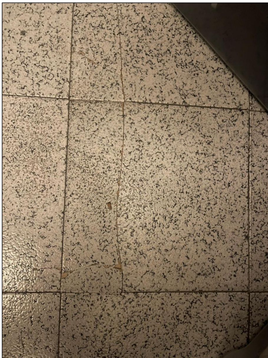
FOTOGRAMMA N. 6 – ALTRA FESSURAZIONE RISCONTRATA NEL PAVIMENTO.
