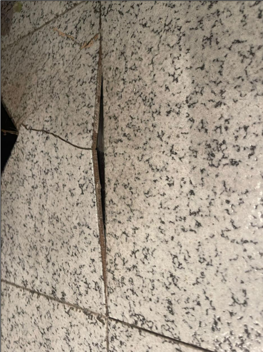
FOTOGRAMMA N. 4 – PARTICOLARE DI UNA DELLE LESIONI RISCONTRATE SUL PAVIMENTO.
