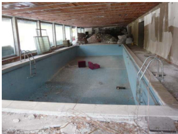
Piscina Piano Secondo sottostrada
